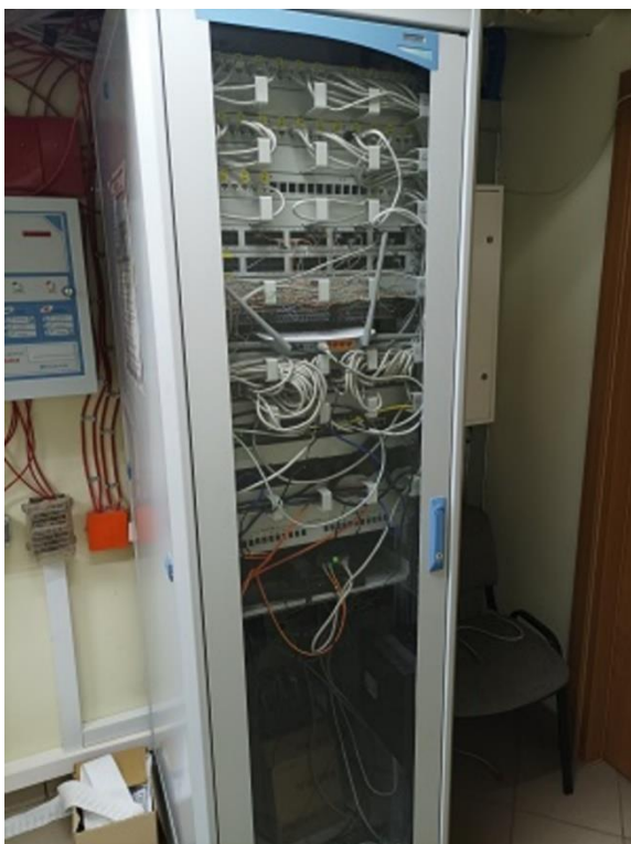
Zdjęcie nr 21: Serwerownia.
