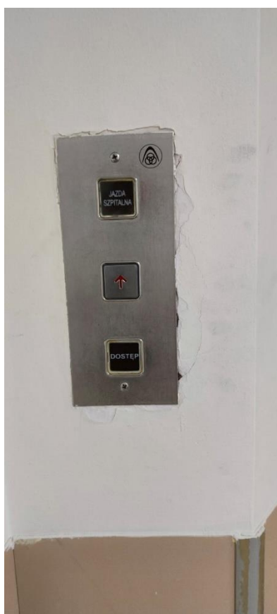
Zdjęcie nr 5: Panel zewnętrzny przy windzie.
